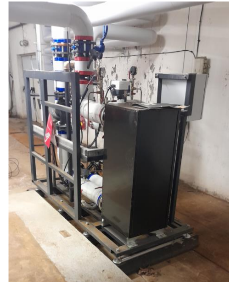
Echangeur de chaleur Lycée Julie DAUBIE - Rombas
