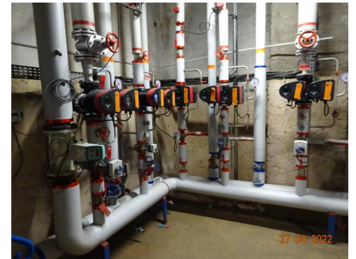
Ensemble de pompes à vitesse variable – lycée Fabert à Metz
