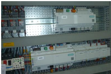
Ensemble d'automates de régulation – lycée de la Tour à Metz
