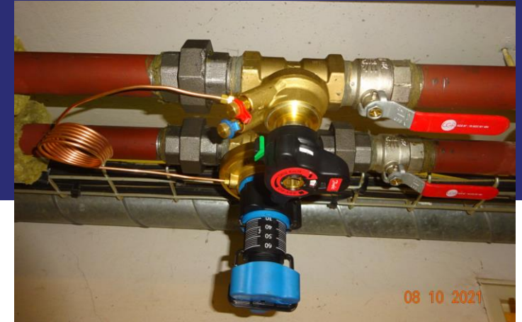
Vannes d'équilibrage en pieds de colonne de chauffage – lycée Chagall à Reims
